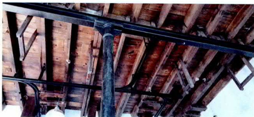
Estructura metálica y la cercha española con el tornapuntas. (Fotografía: José Silva Cano).
